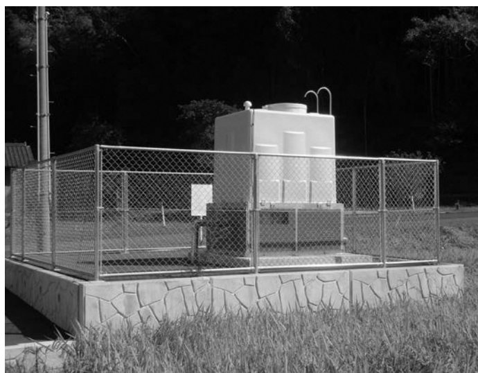
神庭谷ポンプ場
