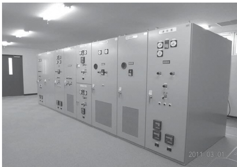
出西水源新ポンプ棟電気室
