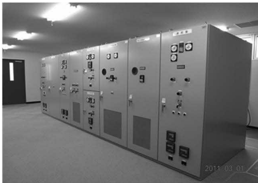
出西水源地新ポンプ棟電気室
