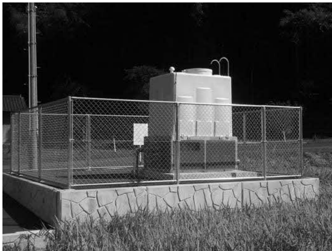
神庭谷ポンプ場
