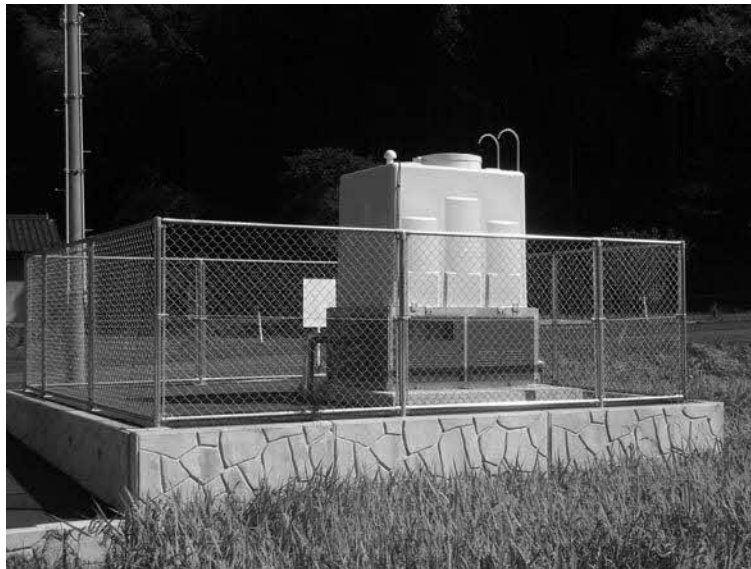
神庭谷ポンプ場
