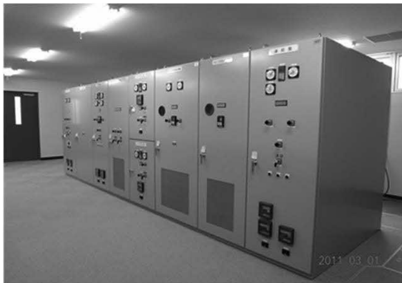
出西水源地新ポンプ棟電気室
