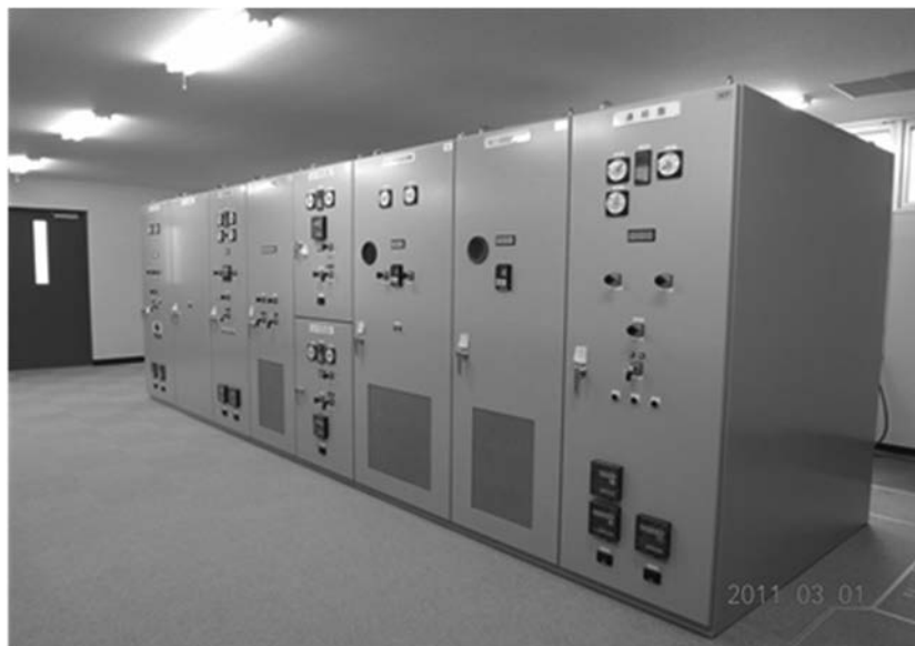
出西水源地新ポンプ棟電気室
