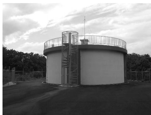
新大野原配水池
