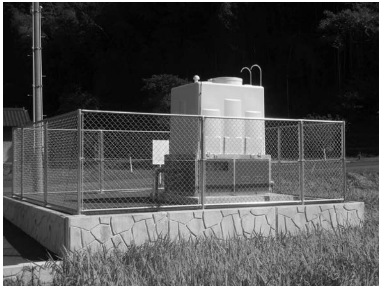
神庭谷ポンプ場
