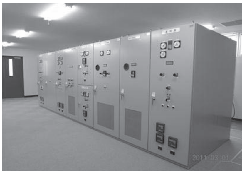
出西水源地新ポンプ棟電気室
