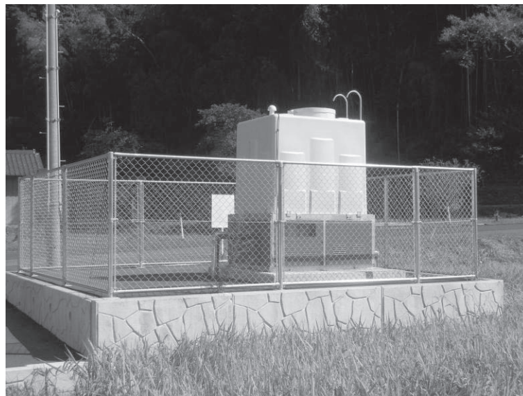
神庭谷ポンプ場
